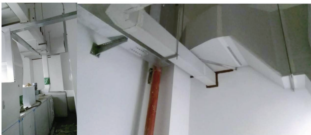
图 5.6 示范房间空调系统风管布置实景
